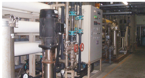
↑排水リサイクルシステム。工場排水を大幅に減らしています。
